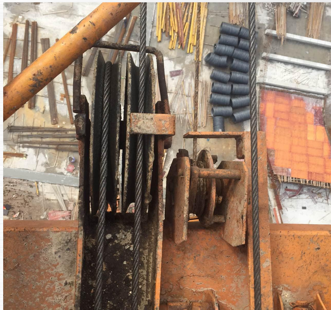
塔式起重机小车滑轮组防脱槽装置失效
