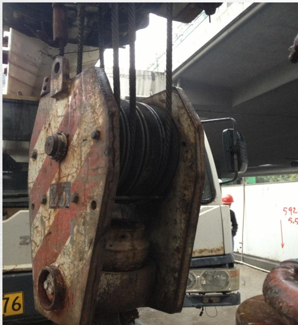
汽车起重机吊钩滑轮组无防脱槽装置
